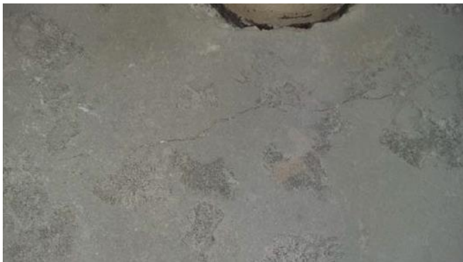
Abbildung 2: Risse im Gebäude
